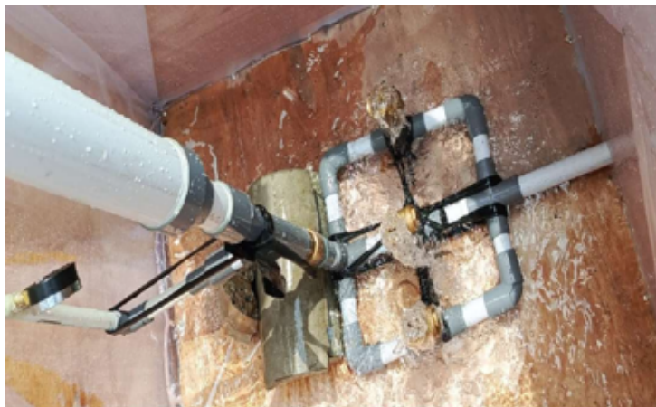
Gambar 1. Rangkaian alat uji pompa hidram
